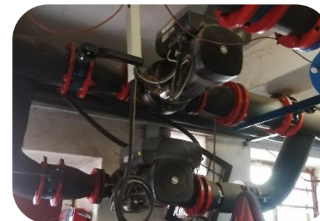
Čerpadlá na rozvod tepla
