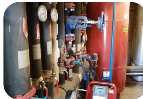
Hlavný rozvádzač tepla
